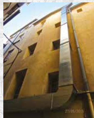
Conduit de fumée.
