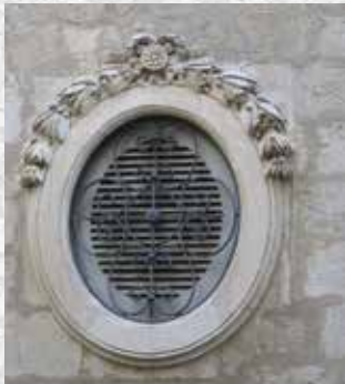
Ventilation : les bouches de ventilation sont intégrées dans un oculus, derrière une grille.
