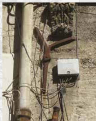
Fils anarchiques, souvent inutiles. Descentes d'eaux usées...
