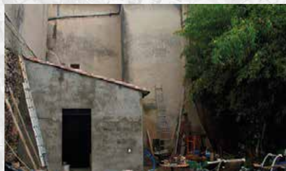
Edicule bâti dont la démolition permettrait de restituer l'emprise du jardin historique.
